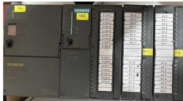
Slika 5. PLC proizvođač Siemens sa modulom za termo parove
