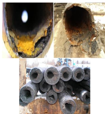
Слика 2. Примери корозије изазване H_2S [8]
