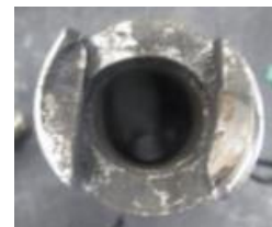
Слика 7. Истрошена вођица шипке [16]
