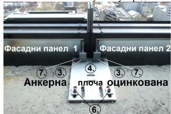
Слика 16. Детаљи везивања Фасадног панела за анкер плочу на бетонску плочу зграде
