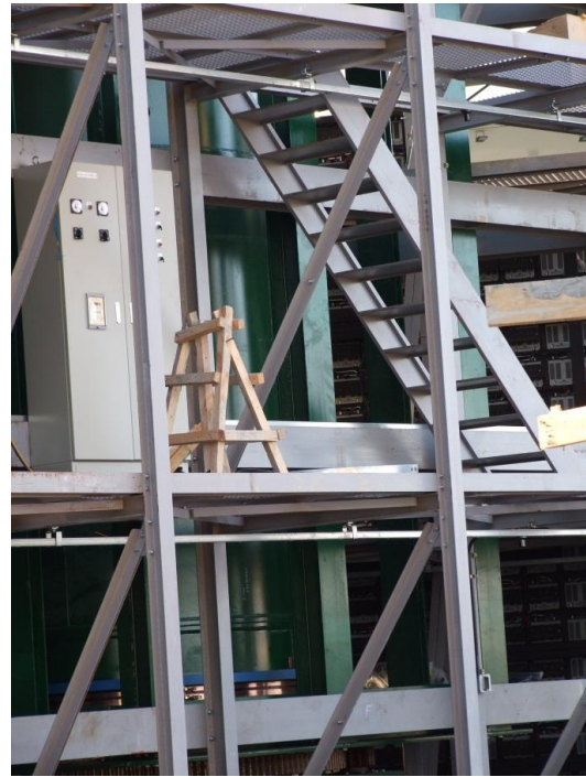
Слика 16. Метална конструкција са електроопремом и међуспратним металним степеништем
