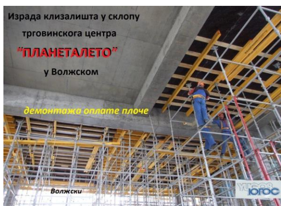
Слика 11. Демонтажа оплате и носеће металне конструкције и осигурање бетонског елемента клизалишта [2]
