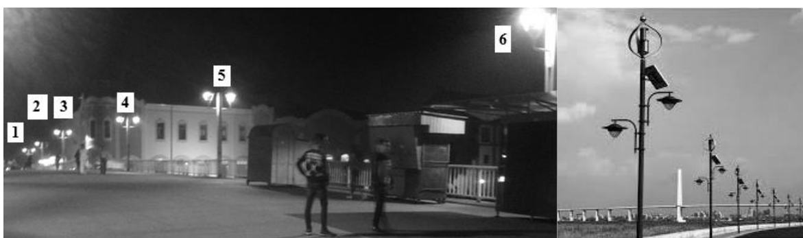
Slika 3.a-desna strana mosta sa led svetiljkama, b-javna rasveta desne strane mosta sa solarnim panelima i vertikalnim vetroturbinama
