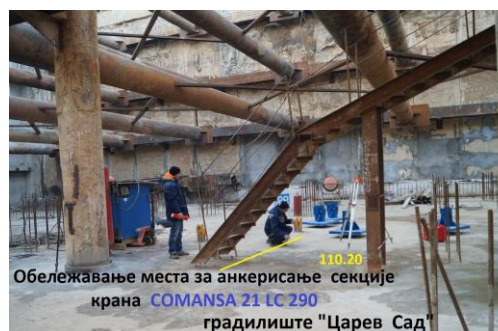
Слика 9. Обележавање места за анкерисање крана LINDEN COMANSA 21 LC 290 на постојећем бетонском темељу на дубини од 13,5m испод нивоа земље испод потпорног система дијафрагми [4]
