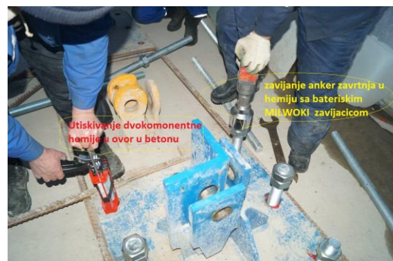
Слика 13. Наношење двокомпонентног лепка МКТ VME помоћу специјалних пиштоља у избушене отворе у бетонском темељу и завијање анкер завртњева M48 снажном батеријском шрафилицом у већ унету хемију [4]
