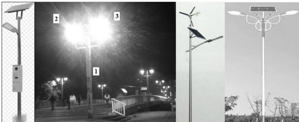
Slika 1. a,c,d-stub javne rasvete sa led svetiljkama desne strane mosta sa solarnim panelima i horizontalnom vetroturbinom, b-postojeći stub sa led rasvetom
